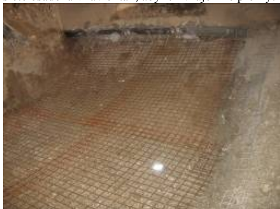
Obr. 9. Zabudovanie výstužných prvkov v technologickej triede IV. časť dno. Fig. 9. Installing of support elements in supporting class IV. part invert.
