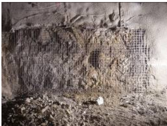
Fig. 5. Installing of support elements in supporting class III, part bench. Obr. 5. Zabudovanie výstužných prvkov v technologickej triede III, časť lavica.
