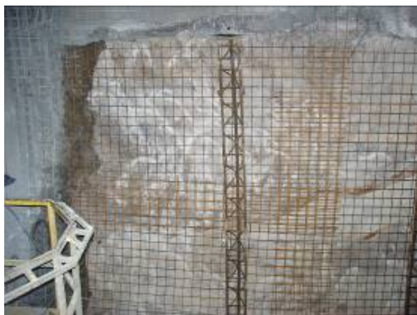
Obr. 13. Zabudovanie výstužných prvkov v technologickej triede IV. časť lavica. Fig. 13. Installing of support elements in supporting class V. part bench.
