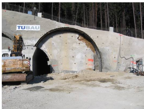
Obr. 6. Začiatok razenia – WP – pravá tunelová rúra. Fig. 6. Start of boring – WP – left tunnel tube.
