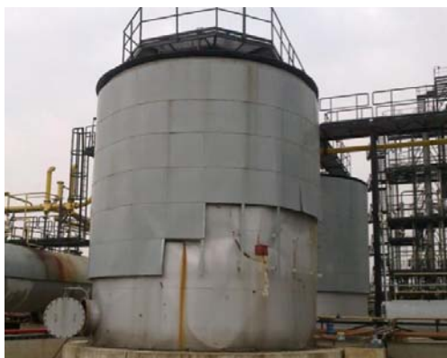
Fig. 1. The high-capacity tank in the Východoslovenská rafinéria, s.r.o.
